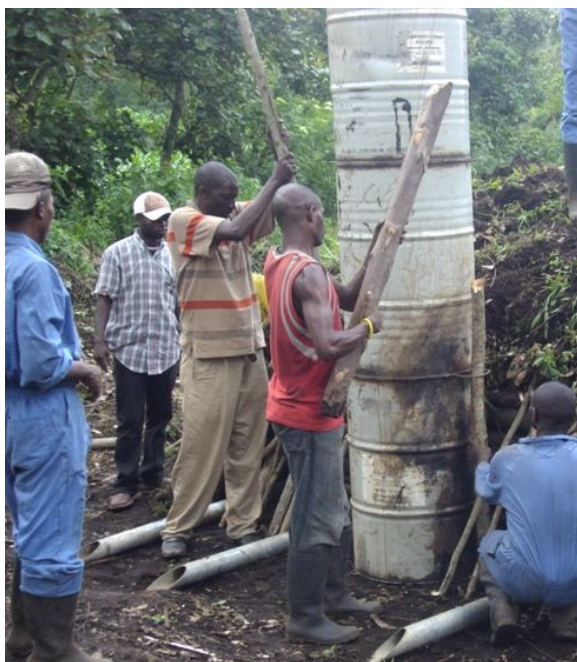
Le montage d'un four moderne avec une cheminée et des événements en bas au cours d'une formation au Nord Kivu
